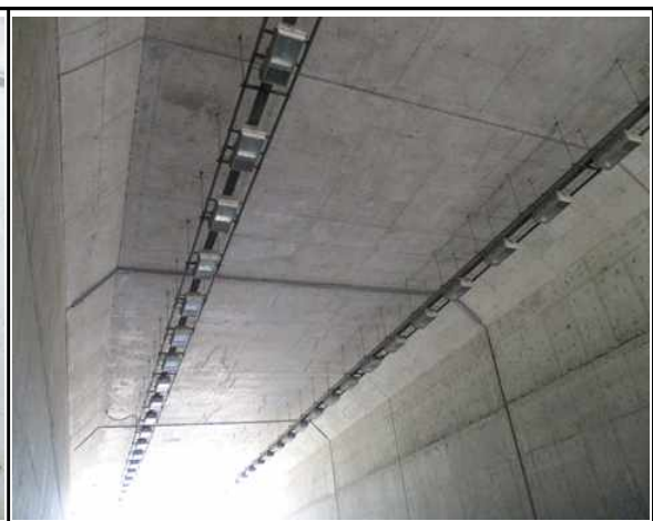
하행선 조명시설 전경
