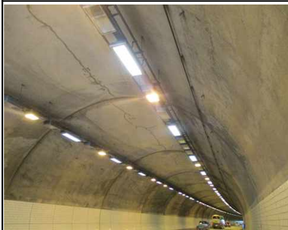
상행선 조명시설 전경
