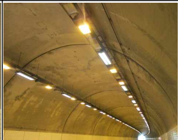
하행선 조명시설 전경
