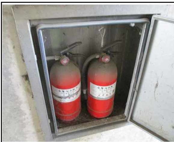
하행선 소화기 전경
