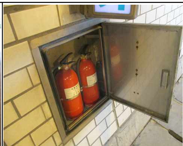
하행선 소화기 전경
