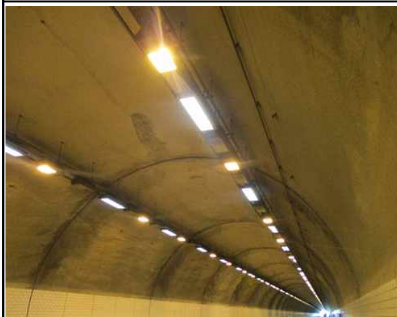
상행선 조명시설 전경
