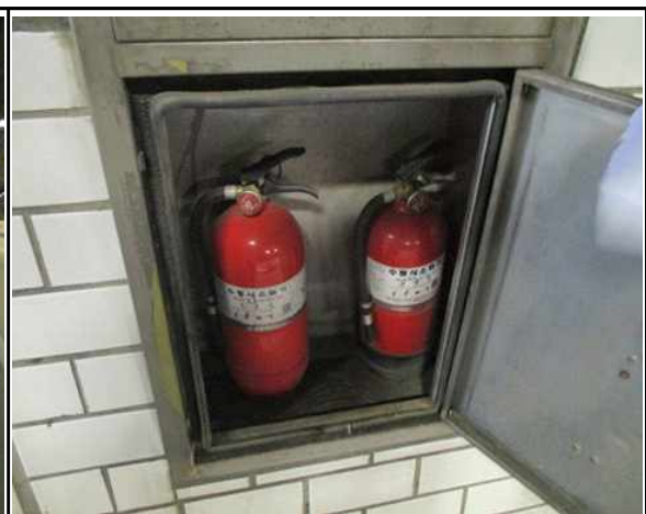
하행선 소화기 전경
