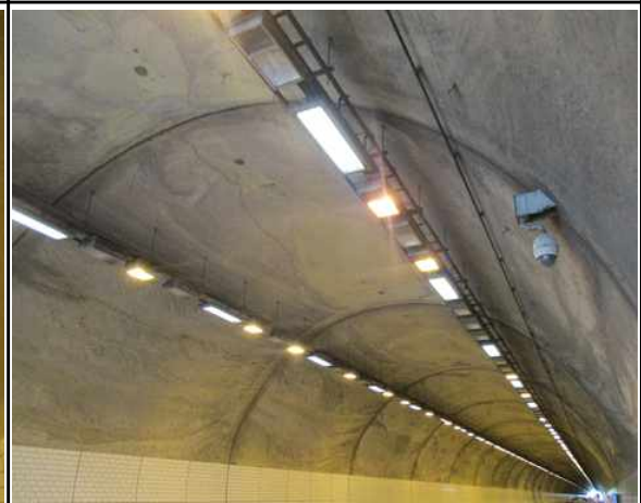
하행선 조명시설 전경
